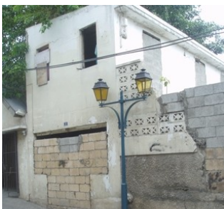
Edifice abandonné, rue de la Liberté... Il abrite des Squatters
